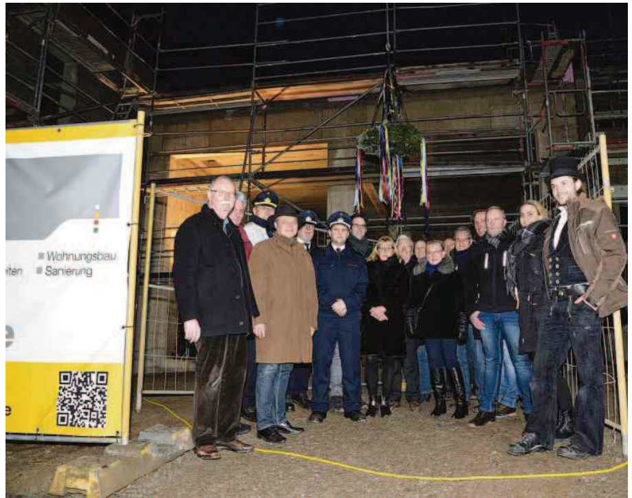
Beim Richtfest der Feuerwehr in Steinenbrück posieren stolz die Besucher mit Bürgermeister Jörg Weigt (im braunen Mantel).
